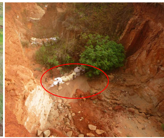
Retention des sédiments par les fascines en bois et sac de terre après la pluie
