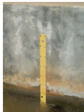
Mesure de niveau d'eau dans le seuil déversoir
