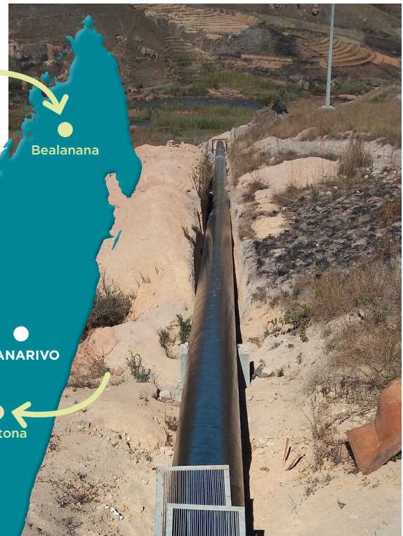
Conduite forcée à Sahatona
