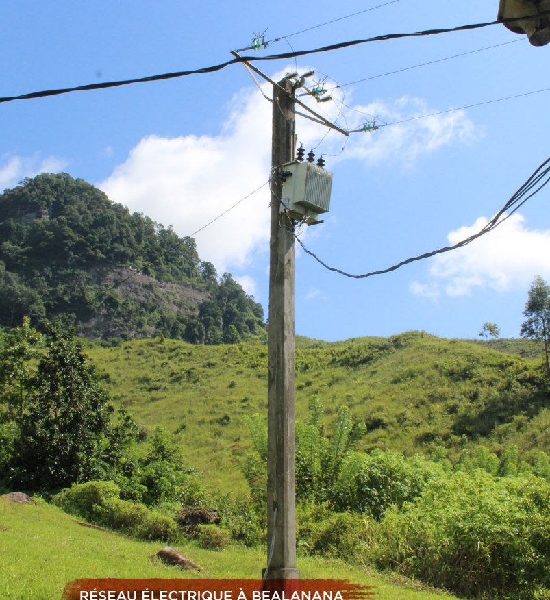
RÉSEAU ÉLECTRIQUE À BEALANANA
